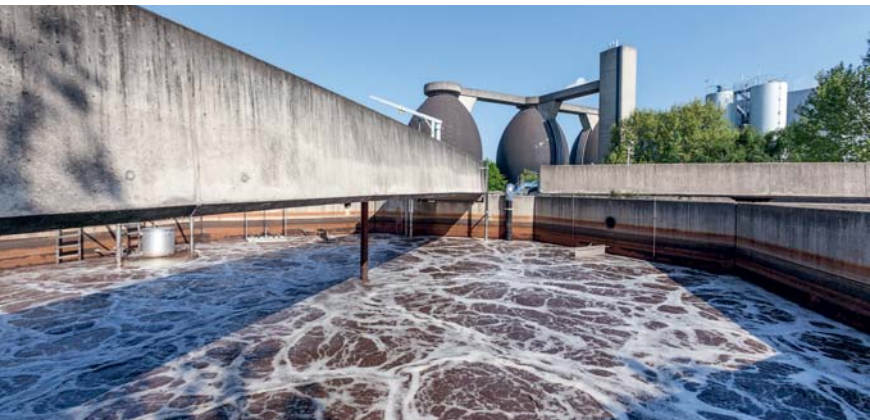
Deammonifikationsanlage (vorn) und Faulbehälter
