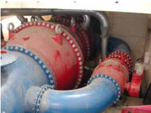
Neues Ringkolbenventil DN 1800 mit Belüftungsrohrleitung sowie Bypassleitung DN 700 mit Ringkolbenventil im rechten Grundablass während der Endmontage im Januar 2002
