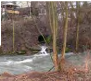
Einleitungsstelle von Niederschlagswasser
